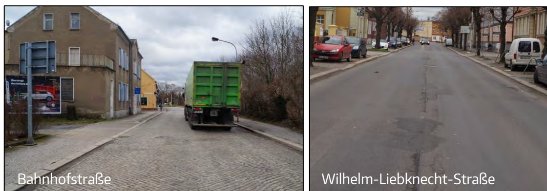
Abb. 8 Oberflächendefizite im Straßennetz mit Verkehrsaufkommen > 3 Mio. Kfz/a
